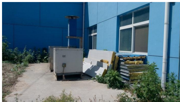
污泥脱水间离子除臭设备
