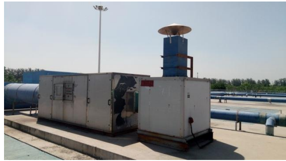
CAST 生物反应池离子除臭设备
